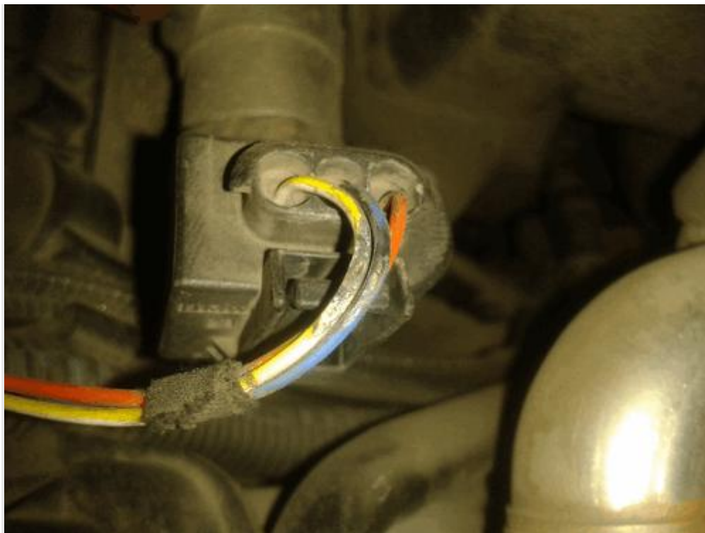
Фото 2 – изоляция протёрта до металла
